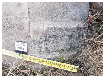
損傷状況写真(近景)
